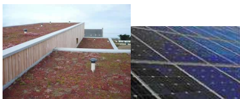
Toiture végétalisée, panneaux photovoltaïques
